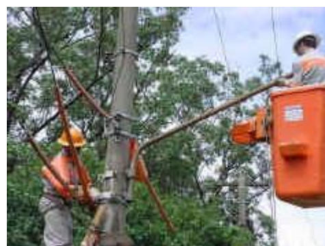
Figura 2 – Posicionamento, alinhamento e fixação do suporte tipo braço no poste com cesta aérea
